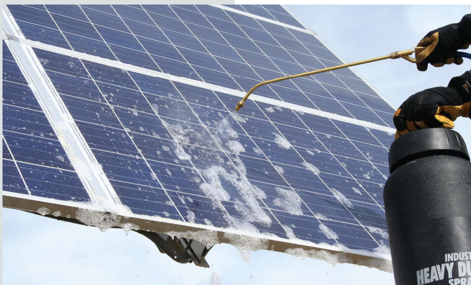
Dung dịch vệ sinh pin được phun trên bề mặt tấm pin
